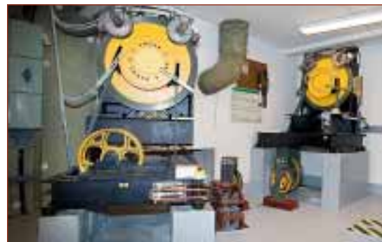
Tyst med växellösa hissmaskiner.
