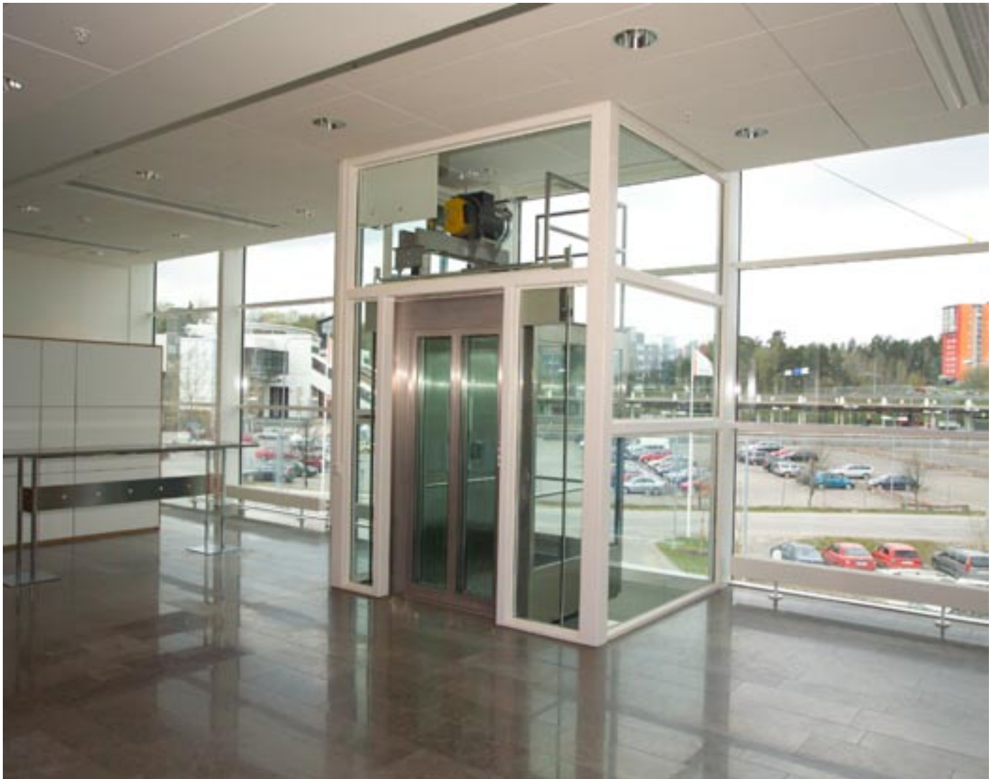
Z-topp med glasad korg installerad i Södertörns Tingsrätts nya fastighet
