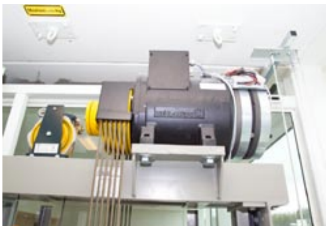
Växellös hissmaskin placerad i schakttopp
